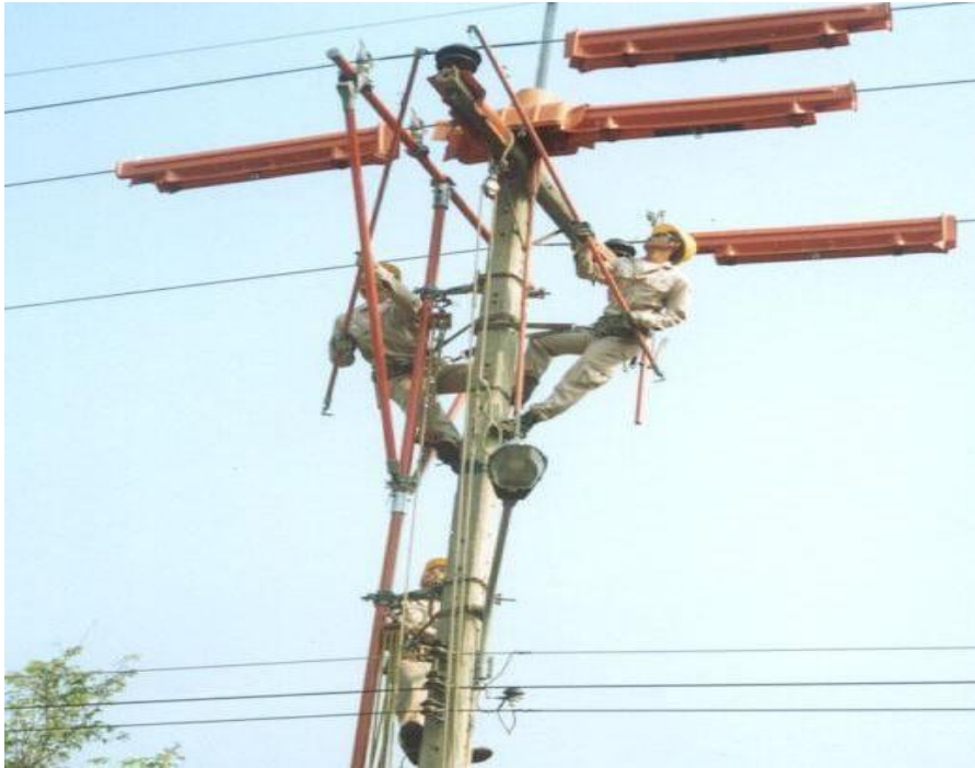
ภาพแสดง : การทำงาน hotline แบบใช้ไม้ฉนวน (Hot Stick)
